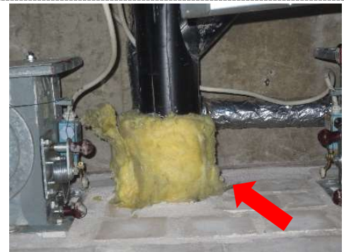
Foto 5.108: KMF-haltige Stopfmasse in Rohrdurchführungen, hier: Beispielfoto Wanddurchführung
