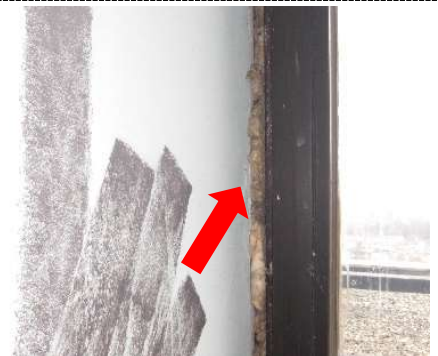
Foto 5.112: KMF-haltige Stopfmasse im Anschluss zwischen Fensterrahmen und Betonbauteilen
