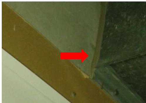
Foto 5.23: asbesthaltige Dichtmassen; hier: U (STU) 10, WC-Raum, Quelle: BUW4, Seite 43
