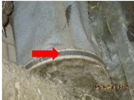
Foto 5.45: asbesthaltiger Dichtstreifen; hier: Modul T, Raum 77, Quelle: BUW4
