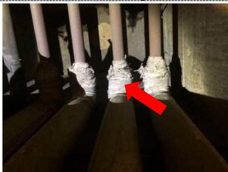
Foto 5.35: asbesthaltige Stricke an Rohrleitungen; hier: Schacht Süd E9
