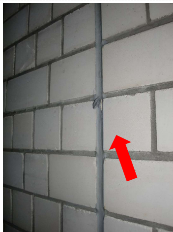
Foto 5.39: asbesthaltige Stricke als Hinterfüllmaterial in Bewegungsfugen KS-Mauerwerk; hier: TRT BZ/F 9
