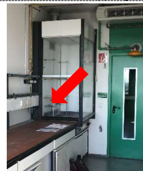
Foto 5.6: asbesthaltige Faserplatte als Verkleidung des Abluftkanalse
