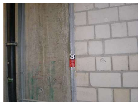
Foto 5.40: asbesthaltige Stricke als Hinterfüllmaterial in Bewegungsfugen KS-Mauerwerk; hier: TRT BZ/F 9
