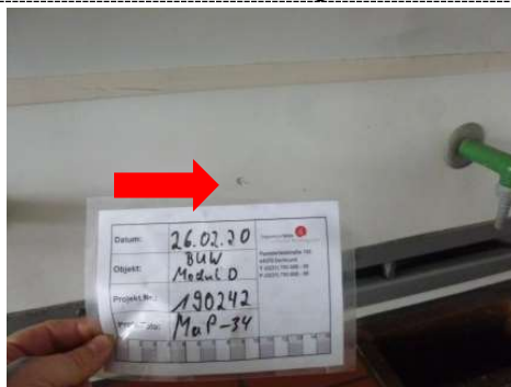
Foto 5.5: asbesthaltige Faserplatte als Verkleidung des Abluftkanals, Gebäude D, 12. OG, Raum 14, Quelle BUW3, Seite 17
