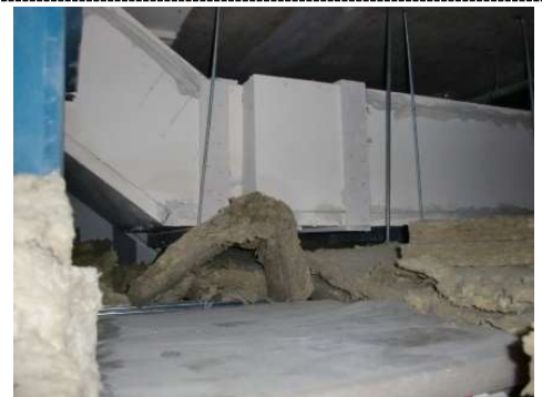
Foto 5.34: Promabest®-Platten als Ummantelung von Elektrotrassen/Lüftungskanälen
