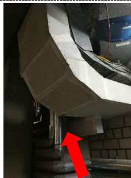
Foto 5.33: Promabest®-Platten als Ummantelung von Elektrotrassen/Lüftungskanälen; hier: Elektrotrasse Technikzentrale
