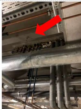
Foto 5.107: KMF-haltige Stopfmasse in Rohrdurchführungen; hier: Modul U, Technikzentrale, Ebene 7, Quelle: BUW6, Seite 18
