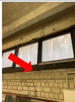
Foto 5.111: KMF-haltige Stopfmasse im Anschluss zwischen Fensterrahmen und Betonbauteilen; hier: Modul U, Technikzentrale, Ebene 7, Quelle: BUW6, Seite 18
