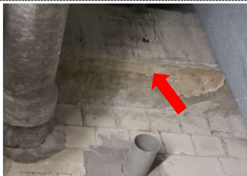
Foto 5.71: Asbestzement zwischen Betonbauteil und Mauer, hier: Ebene 14, Raum 70, Quelle: BUW2, Seite 23
