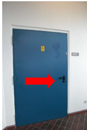
Foto 5.52: FH- Türen mit asbesthaltigen Pappen im Treppenturm BZ/O/P, Foto im Rahmen der Begehung
