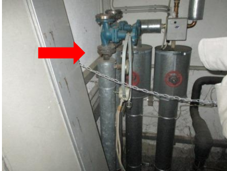
Foto 5.4: Flachdichtung in Flanschen, hier: Gebäude FB, Quelle: BUW1, Seite 33
