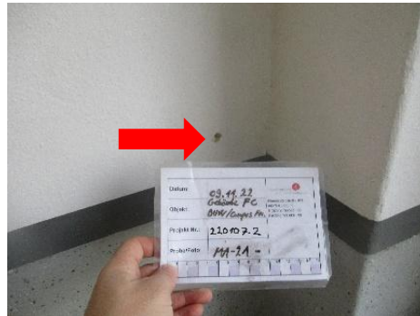
Foto 5.8: asbesthaltiger Putz; hier: auf Massivwand, Gebäude FC, 2. OG, Flur, Räume 2.82, 2.83, 2.84, Quelle: BUW1, Seite 33
