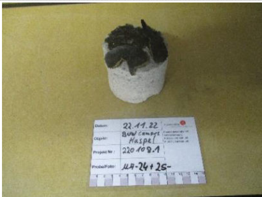
Fotos 6.22: PAK-haltige Abdichtung im Bodenaufbau, Gebäude HF, EG, Labor 00.04
