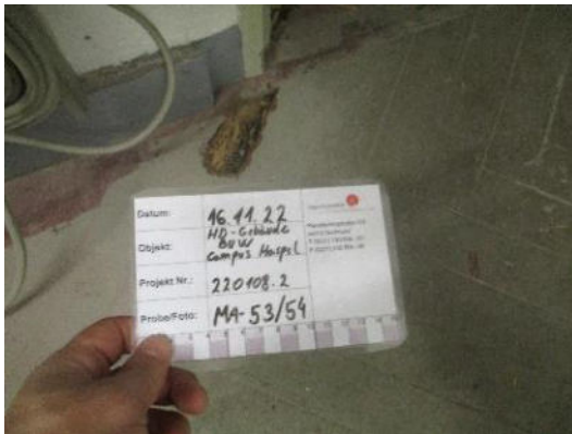
Fotos 6.21: PAK-haltiger Kleber unter Parkettboden, Gebäude HD, KG, Raum 01.12, Telefonverteiler
