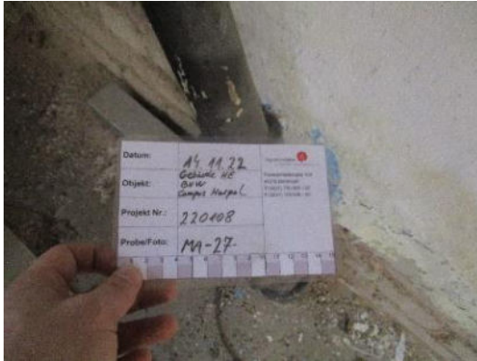
Fotos 6.20: PAK-haltiger Anstrich auf Rohrleitung, hier: Gebäude HE, KG, Raum hinten links
