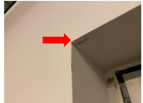
Foto 5.10: asbesthaltige Spachtelmassen, hier: Gebäude HF, 2. OG, Flur, Quelle: BUW 8, Seite 18
