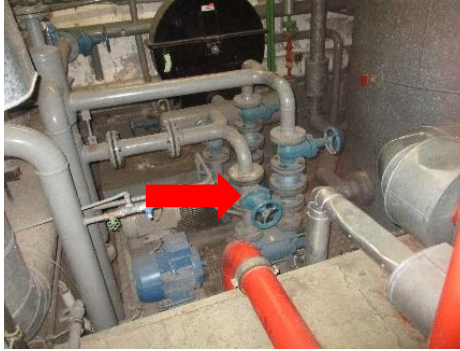
Foto 5.3: Flachdichtung in Flanschen, hier: Gebäude HD, KG, Heizungszentrale, Quelle: BUW1, Seite 33
