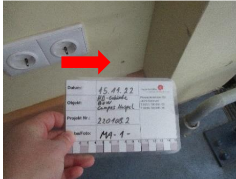
Foto 5.7: asbesthaltiger Putz; hier: auf Massivwand, Gebäude HD, 3. OG, Raum 3.35b, Quelle: BUW1, Seite 29
